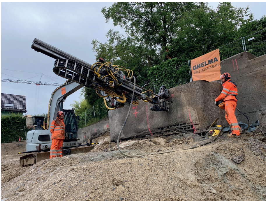
Bohren ohne schwere Handhabungen von Bohrrohren, dadurch kleinere und ökologischere Bohrgeräte mit über 70 Prozent weniger CO 2 -Ausstoss.
