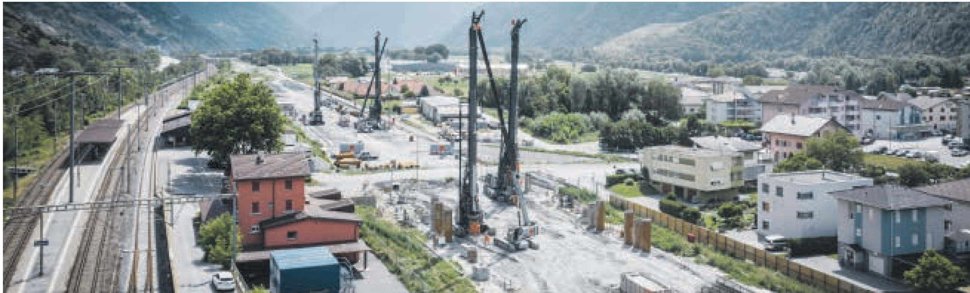
Blick nach Osten. Wo nun die Bohrtürme stehen, führt in einigen Jahren die A9 mitten unter Raron hindurch.
